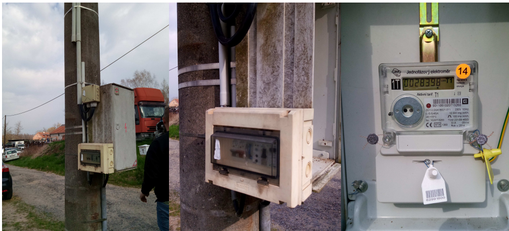
Obrázek 3: Celkový pohled, detail rozvaděče a detail elektroměru
