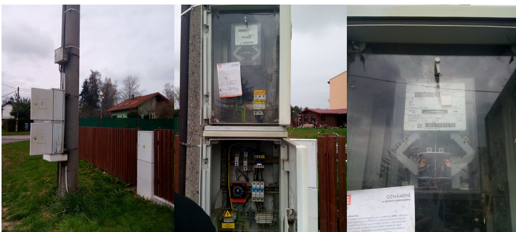
Obrázek 4: Celkový pohled, detail rozvaděče a detail elektroměru
