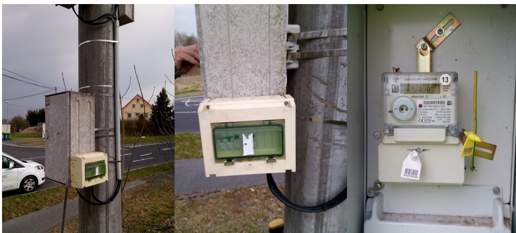
Obrázek 2: Celkový pohled, detail rozvaděče a detail elektroměru
